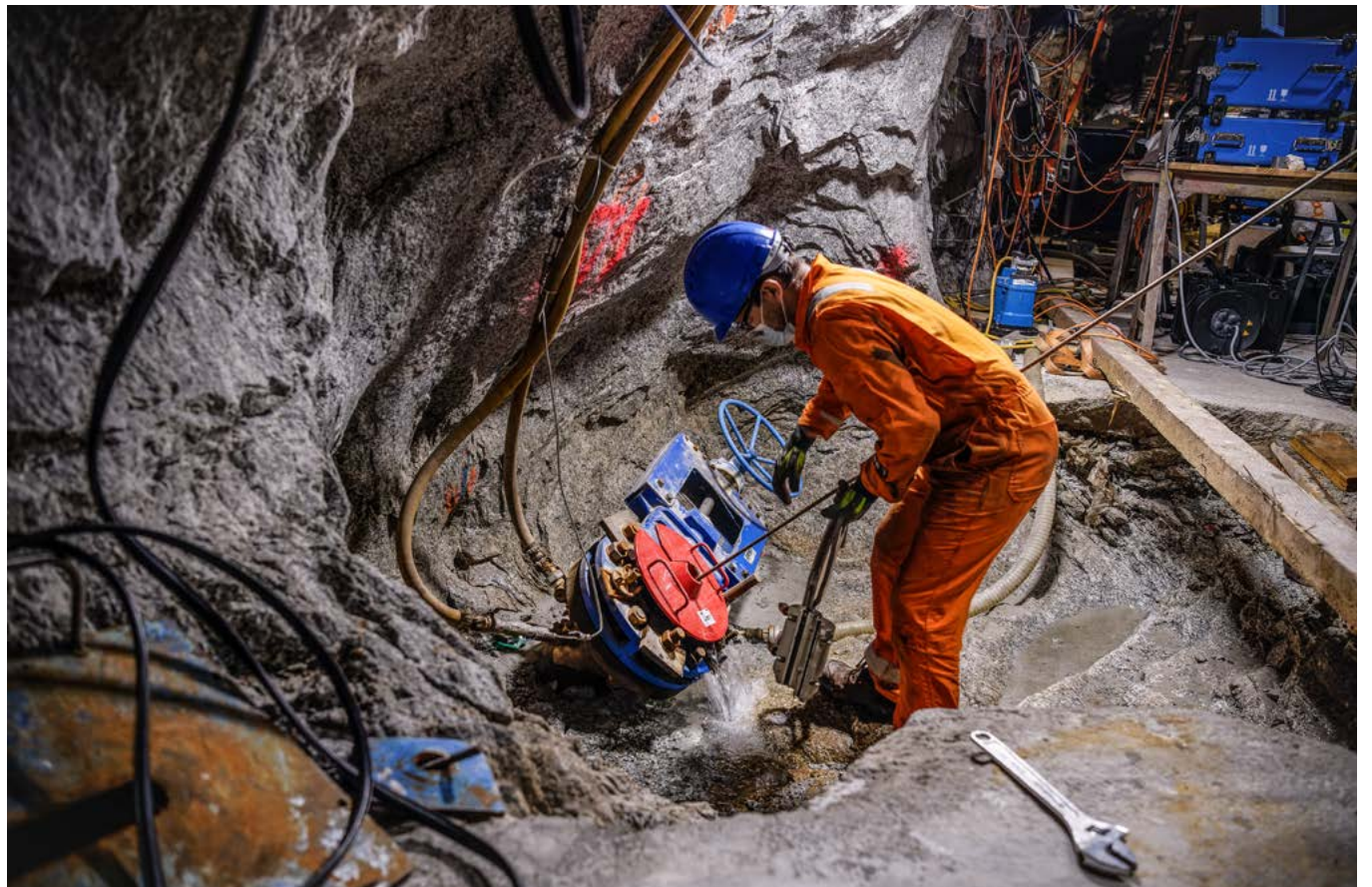
Zentraler Bestandteil des zweiten Untergrundlabors wird das Bohrloch sein (auf dem Bild mit rotem Deckel verschlossen). Es muss rund 20 cm Durchmesser aufweisen, damit die zahlreichen aufzeichnenden und überwachenden Sensoren eingeführt werden können.
